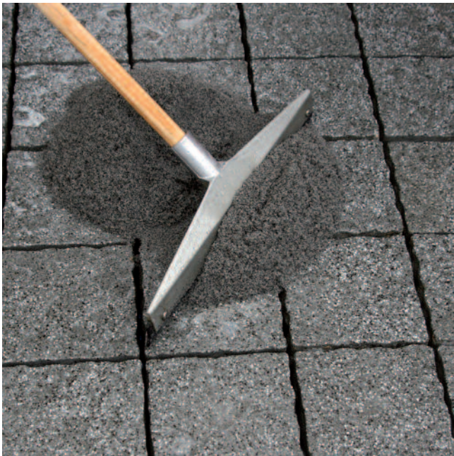
PCI Pavifix 1K Extra mit einem Gummischieber unter Druck in die Fugen einarbeiten.
