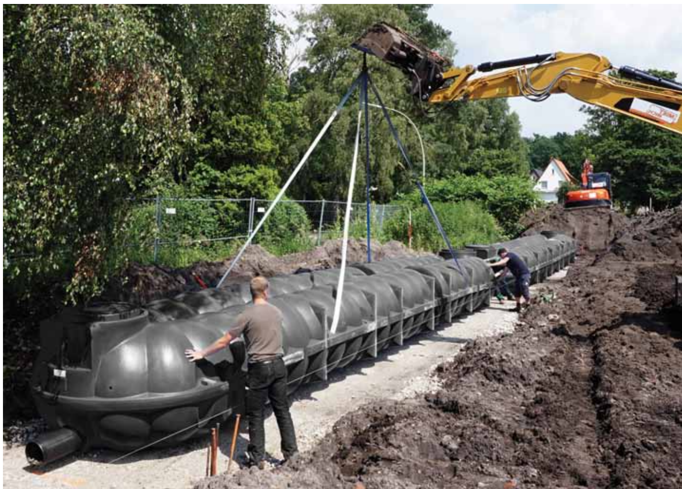
Praxisbeispiel: 100.000 Liter Anlage mit vier NEOplus Retentionsspeichern a 25000 Liter
